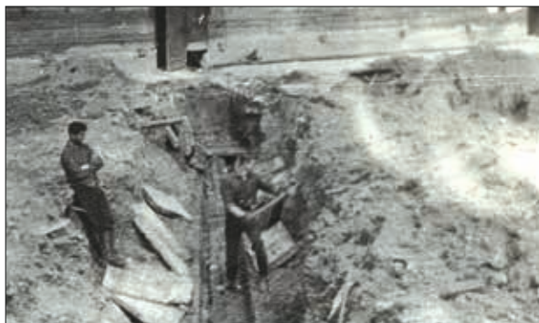
Какой-никакой, а трубопровод...
