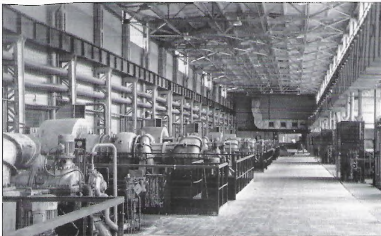
Турбинный цех компрессорной станции.
